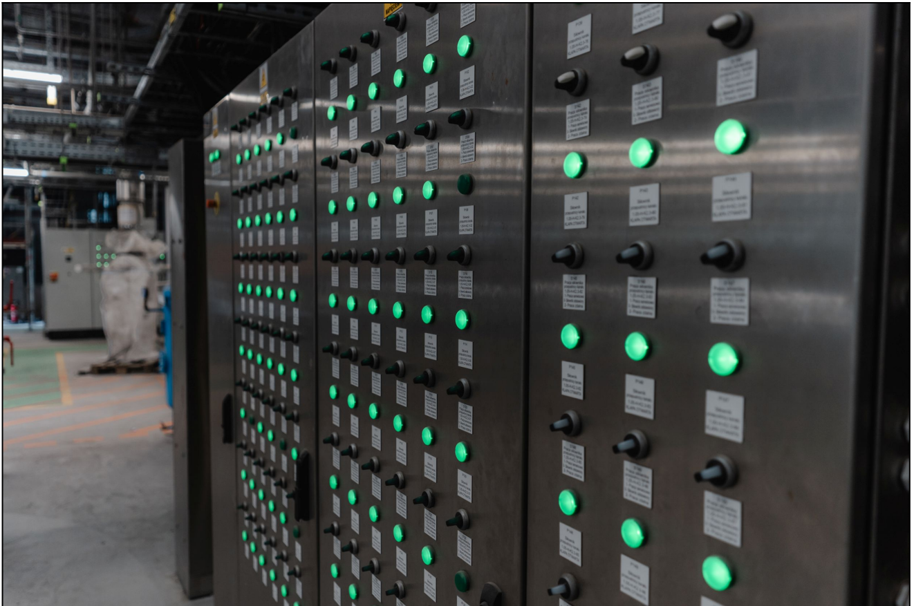
Prefabrykacja rozdzielnic niskiego napięcia
