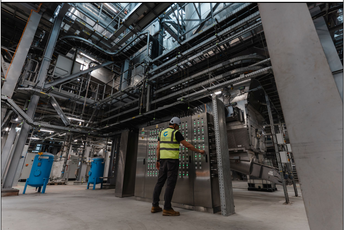
Systemy automatyki budynkowej i BMS
